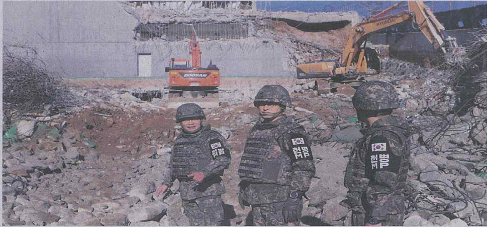
남북 전방 GP 동시철거 시작 · 남북이 냉전 시대의 산물인 전방 GP(감시초소) 철거작업을 12일부터 시작했다. 김용우 육군참모총장(가운데)이 이날 중동부전선 철원지역 GP를 방문해 굴착기로 철거하는 현장을 둘러보고 있다. 사진제공=육군
