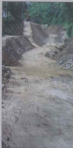
영월군이 식수난을 겪는 영월읍 영흥1리 속칭 속골마을 오무천 일대 소하천 정비공사를 하고 있다. 영월/방기준
